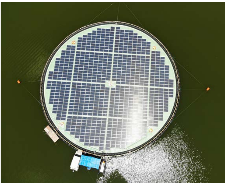
Solcellepaneler produserer bedre ved lave temperaturer. De mest utbredte teknologiene for flytende solkraftverk er i svært liten grad designet for å utnytte muligheten for vannkjøling. Direkte kjøling er en av fordelene ved norske Ocean Suns teknologi. Foto: Børge Bjørneklett/Ocean Sun
